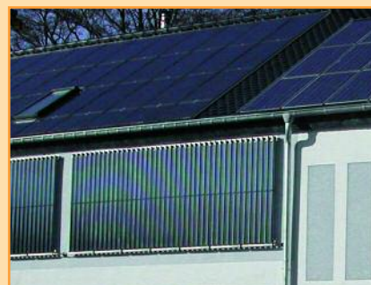
Mit Photovoltaik kombinierte TUBO-Fassaden-Anlage, Luxemburg
